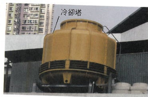
圖 2.2i 大型空調系統的冷卻塔
